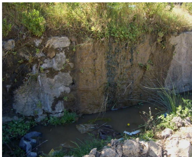
Figura 51: Surgencia de agua en núcleo urbano de Belyounech. Fuente: Elaboración Propia.
